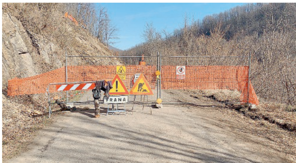
COLLE DI CASALETO La strada comunale interrotta a causa del movimento franoso.
